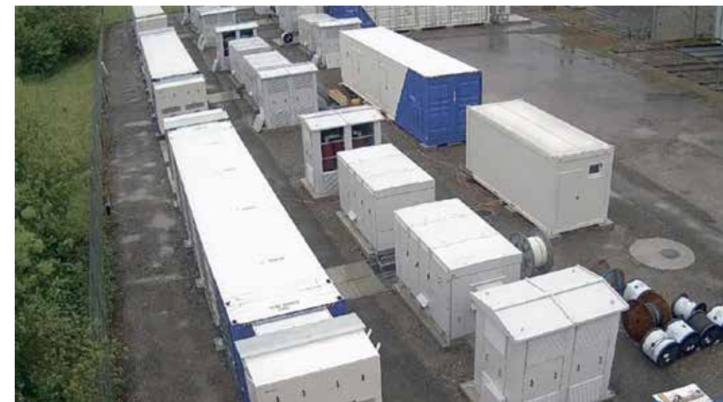
Die Grossbatterie soll zunächst Sekundärregelleistung erbringen, später dann auch Primärregelleistung. Bild: MW Storage
